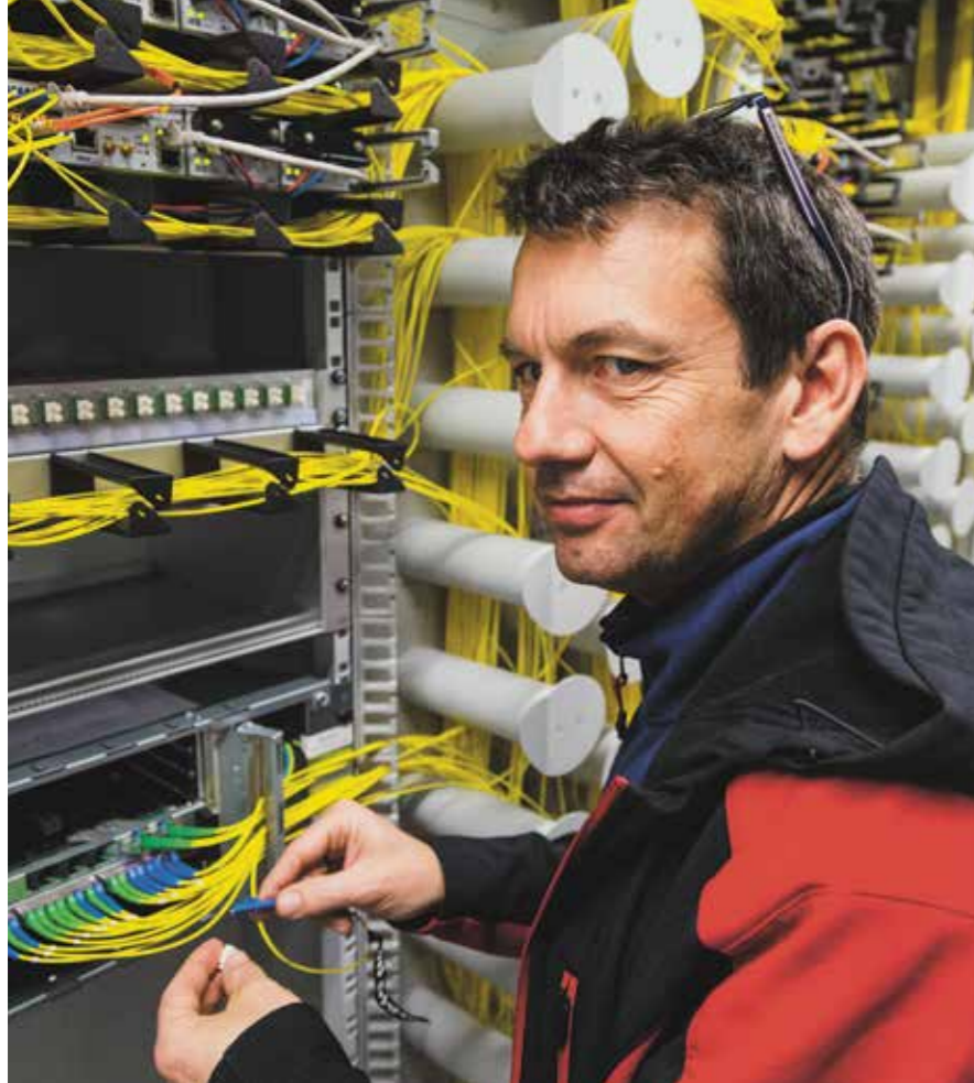
Alexander Wimmer im Rechenzentrum der Stadtwerke.
