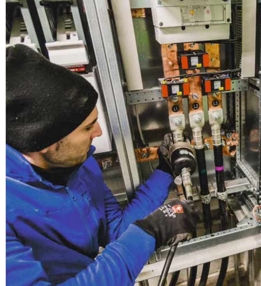
Christian Dressler bei Arbeiten in der Trafostation Alte Saline.
